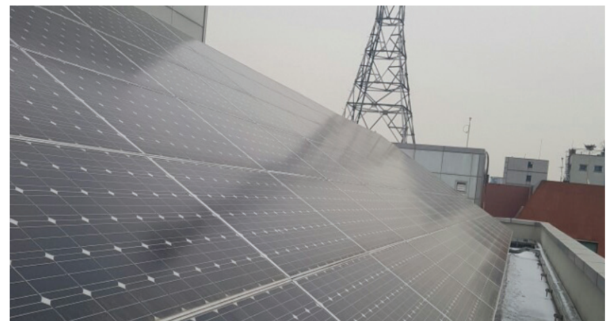
△ K-BEMS 신재생 발전 기술 중 하나인 태양광 발전기
